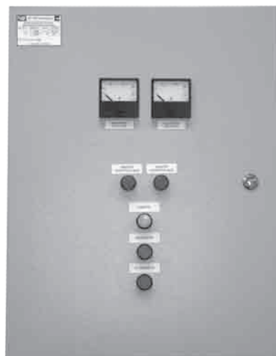
Устройство автоматического ввода резерва
